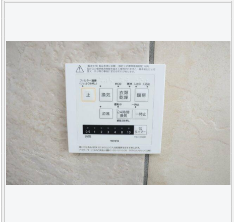
浴室換気乾燥暖房機、24時間換気リモコン
