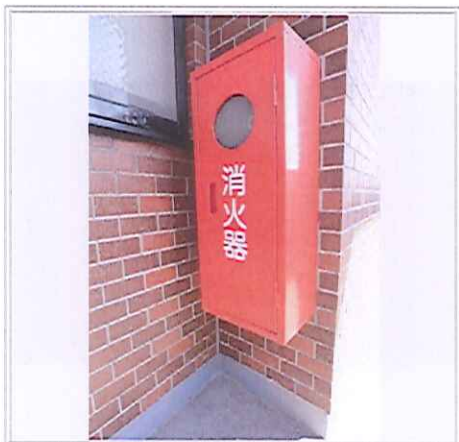
玄関横消火設備
