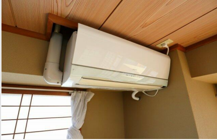
和室にはエアコン1台付！
