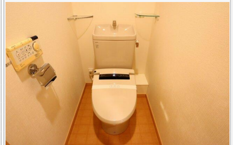
自動洗浄機付トイレ
