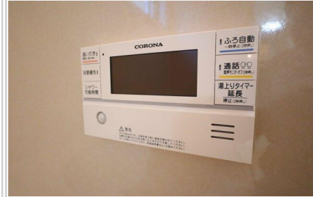
浴室内コントロールパネル
