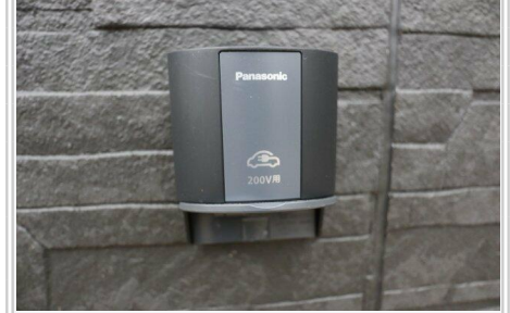
電気自動車対応のコンセントも設置済み
