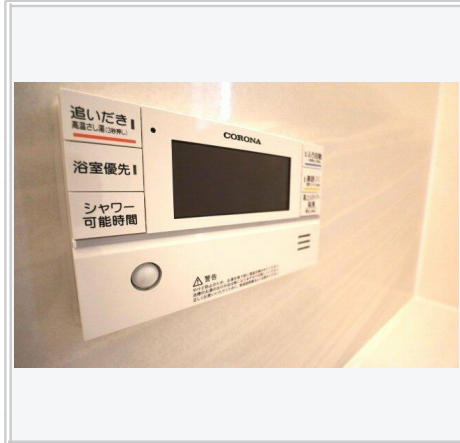
浴室内コントロールパネル
