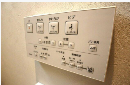
1階温水洗浄便座付トイレ 壁掛けコントロールパネル
