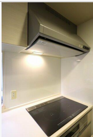
キッチンの壁面には、大型不燃パネルを採用。 こびりついた油污れも、さっと一拭き！簡単お 手入れで美しさ
