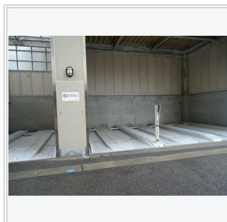
機械式駐車場
