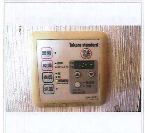
浴室乾燥暖房機 コントロールパネル
