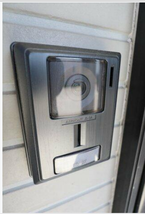
玄関横のモニター付インターホン
