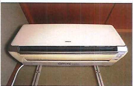
1階 ダイニングエアコン
