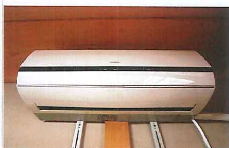
1階和室 エアコン
