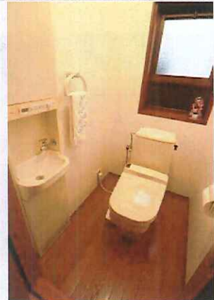
手洗い場・温水洗浄便座付きのトイレ
