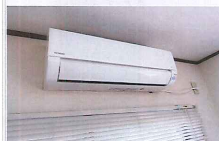
事務所 エアコン（日立2020年製 5.6kW）
