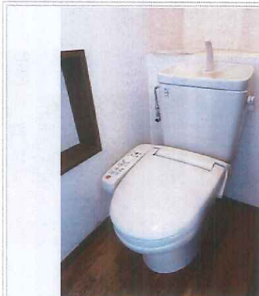
2階トイレ 手洗いと温水洗浄便座付き
