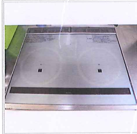
2Fキッチン3口のIHクッキングヒーター
